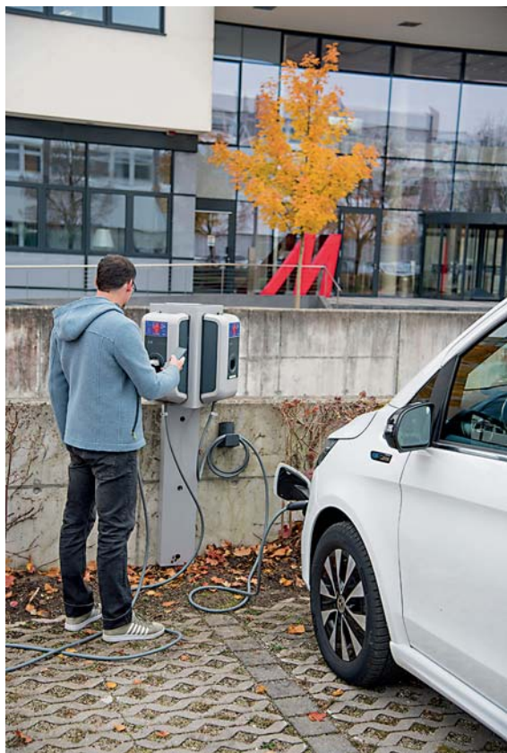
Am Firmensitz in Ingolstadt können auch Besucher Strom laden. Der Typ-2-Stecker ist praktischerweise an der Säule
