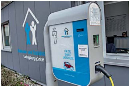
Zwei Ladepunkte pro 11-kW-Wallbox, die an den sieben Stationen installiert wurden
